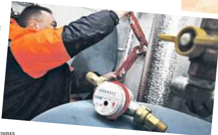
Трубы в подвале требуют ремонта
